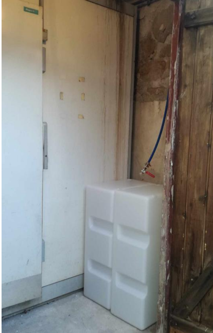
2 cuves de 130L (local très petit)
