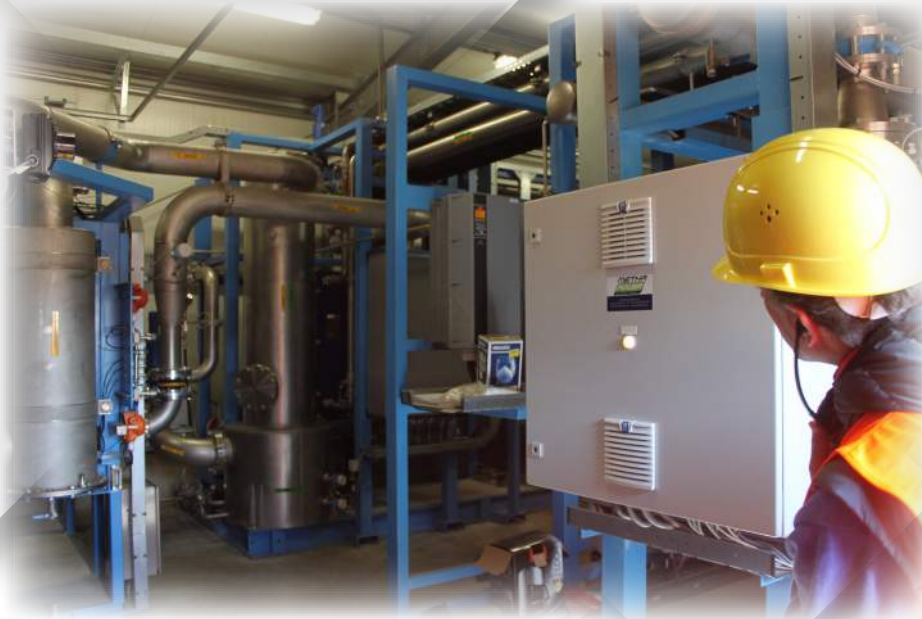
Le système d'épuration à membrane du biogaz de l'unité AVA (Source: D. Rutz, WIP)
