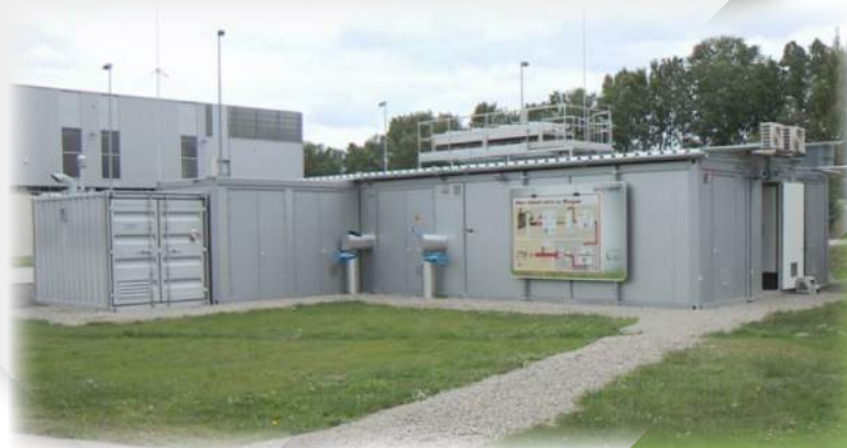
Épuration et injection du biométhane (Image: Ville de Vienne/WKU/)
